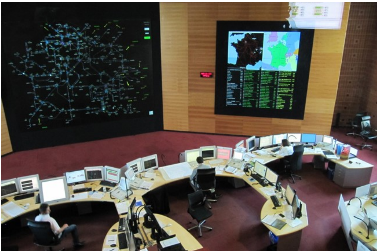
Le centre de contrôle du réseau haute tension (RTE)
