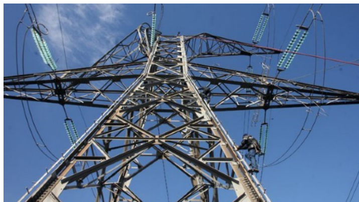
Ligne haute tension
